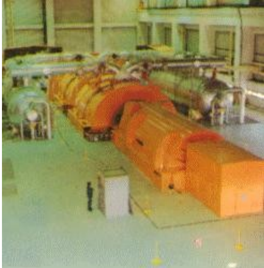
Slika 5: Turbina in generator
