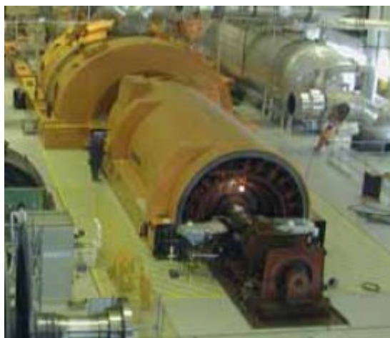
Slika 30: Turbina in generator
