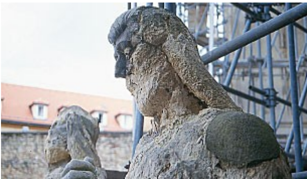
Poškodbe, ki jih povzročajo kisel dež (stolnica v Zagrebu)
