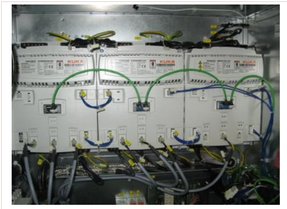
Slika 8.7 : Servoregulator pogona robota
